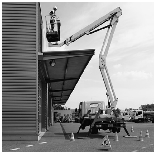
4 Le lieu d'intervention doit être signalé de manière à ce que les passants ne pénètrent pas dans la zone dangereuse de la PEMP.
